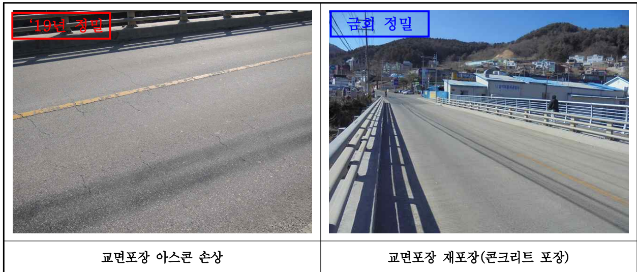
【사진 1.3.20】 교면포장 손상현황
