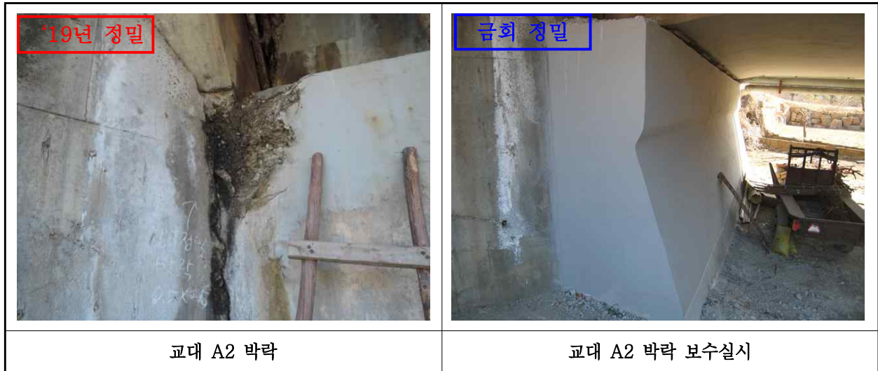
【사진 1.3.9】 교대 손상현황(계속)
