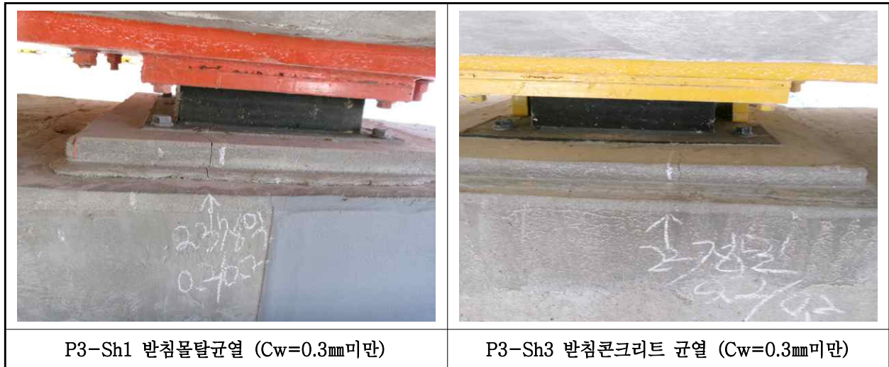
【사진 1.3.13】 교량받침 손상현황
